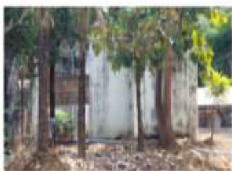
ถังเก็บน้ำ พ.33 ปีที่สร้าง 2536
